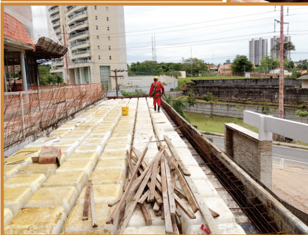
Situações de risco de queda de trabalhadores e projeção de materiais comumente detectadas em obras de todo o país. A tônica, em todos os casos, é a inexistência de proteções coletivas nos locais de trabalho. Fotos registradas por Auditores Fiscais do Trabalho em diferentes estados e regiões do Brasil entre 2012 e 2015.
